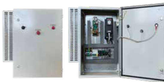
Шкаф управления лебедкой
